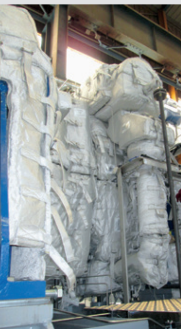
I Corps de turbine
