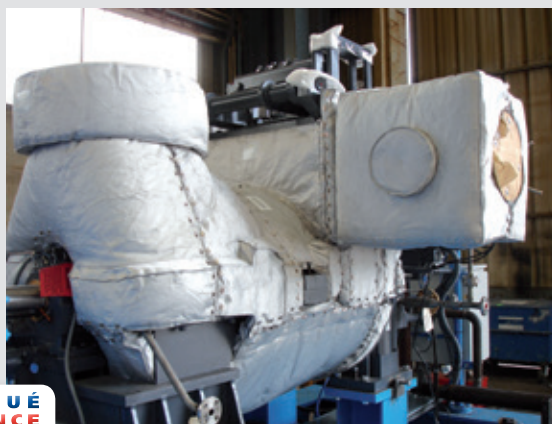
I Turbine isolée
